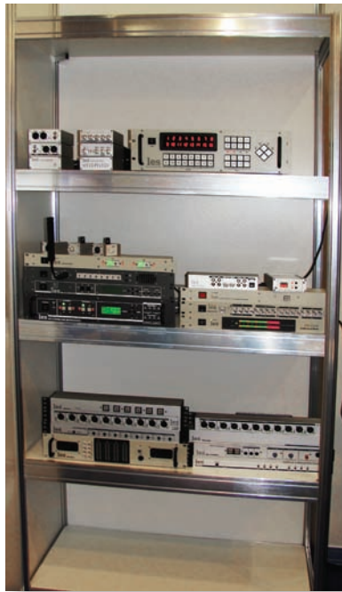
Оборудование на стенде ЛЭС-ТВ
